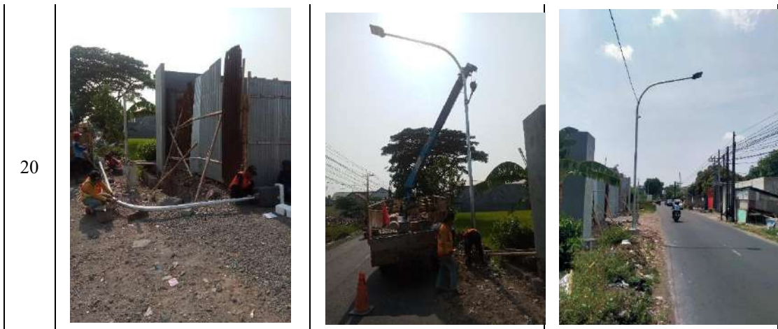
Gambar 13. Tiang Penerangan Jalan Umum di Ruas Jalan Waringin-Konimeks
