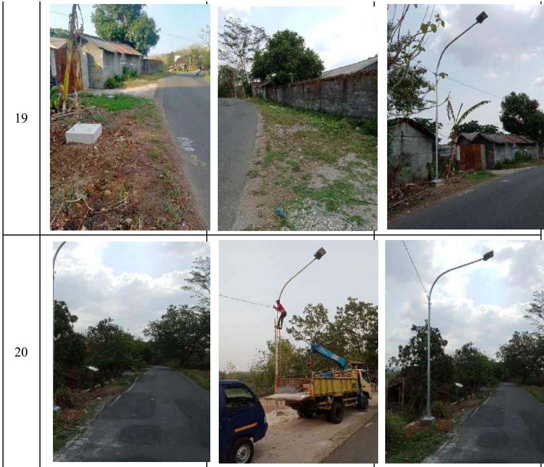
Gambar 14. Penerangan Jalan Umum di Ruas Jalan Pengkol Jangglengan
