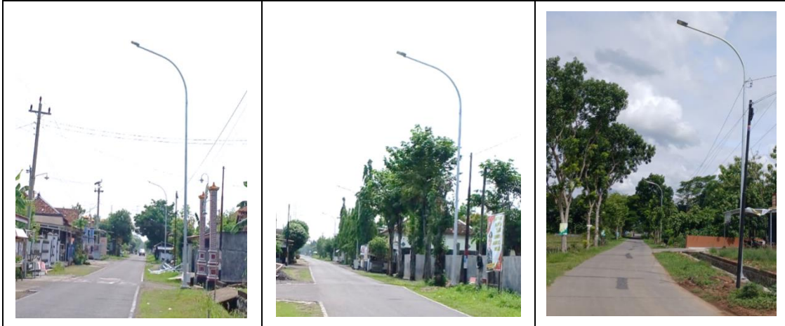
Gambar 21 Tiang Penerangan Jalan Umum 9Meter di Ruas Jalan Dalangan -Lengking
