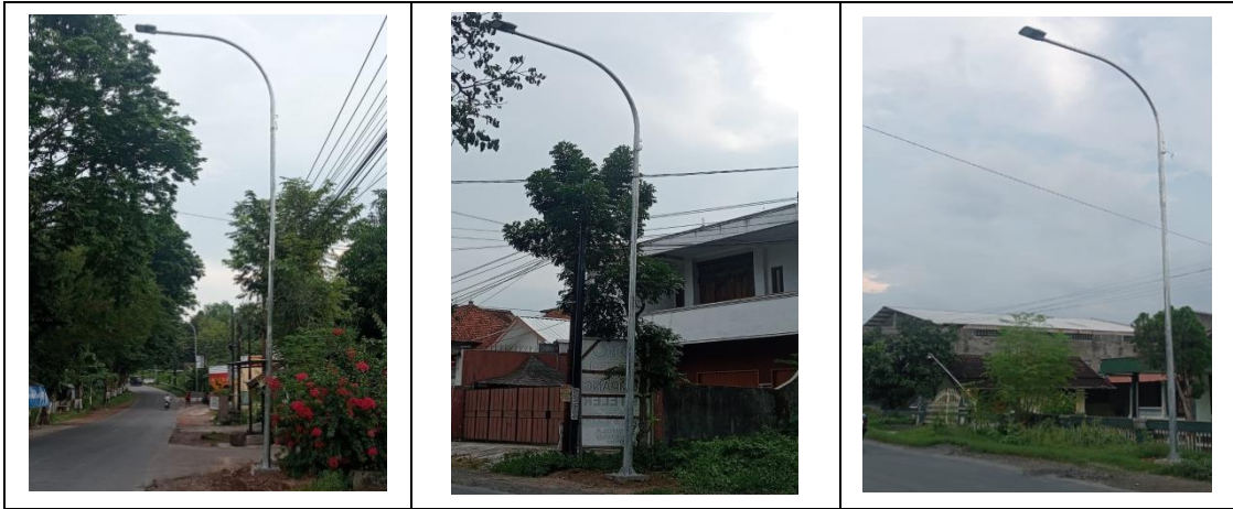
Gambar 10 Tiang Penerangan Jalan Umum 9Meter di Ruas Jalan Telukan - Pasar Cuplik
