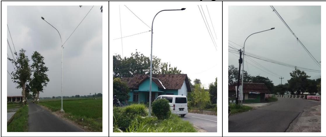
Gambar 14 Tiang Penerangan Jalan Umum 9Meter di Ruas Jalan Tinggen - Stasiun Gawok
