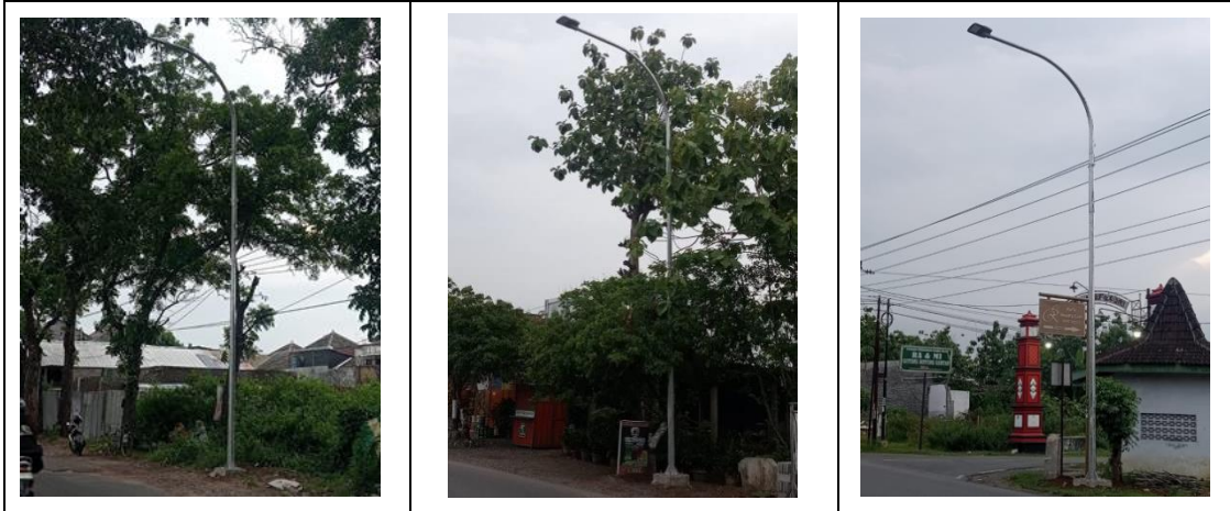
Gambar 18 Tiang Penerangan Jalan Umum 9Meter di Ruas Jalan Gentan - Bekonang
