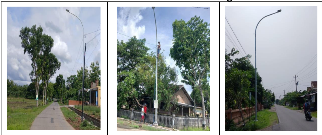
Gambar 19 Tiang Penerangan Jalan Umum 9Meter di Ruas Jalan Ngasinan - Bulu
