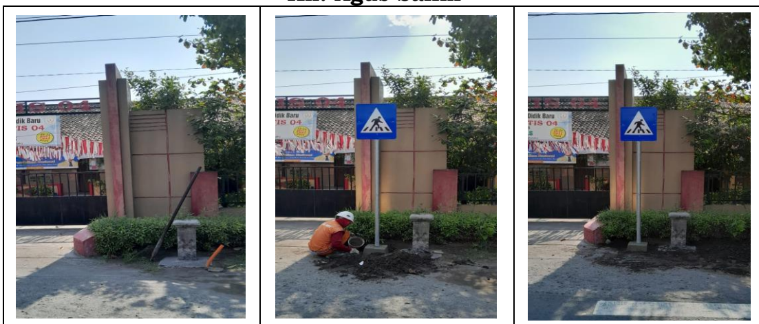
Gambar 25 Rambu Perlengkapan Jalan di Ruas Jalan kh. Samanhudi
